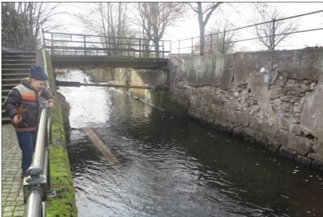
Figur 33. Vulcan A – den vänstra fårans strandskoningar och kajer är bitvis i mycket dåligt skick och i stort behov av reparation.
